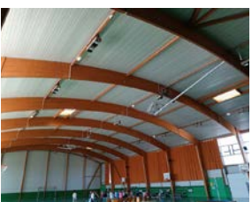
Éclairage salle de sports
